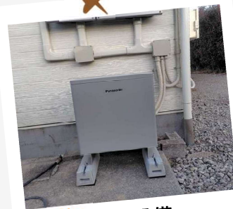
☀ 導入設備 発電システム4.7kW 蓄電池 6.4kWh
